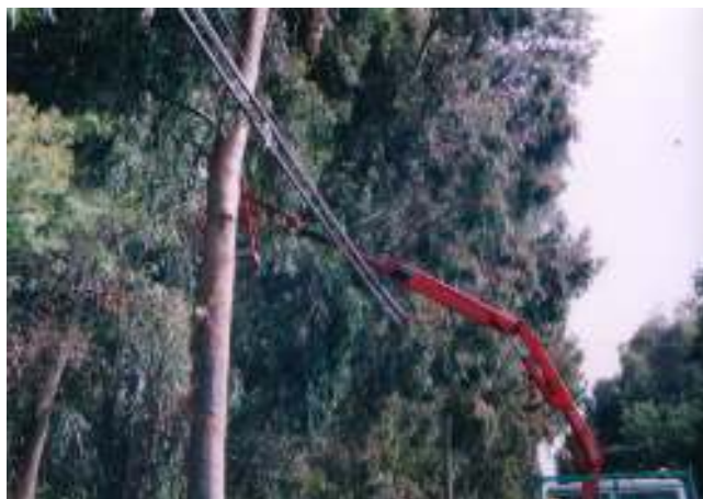
Foto 32 Difficoltà nelle operazioni di manutenzione dei filari a ciglio strada a causa dei cablaggi aerei
