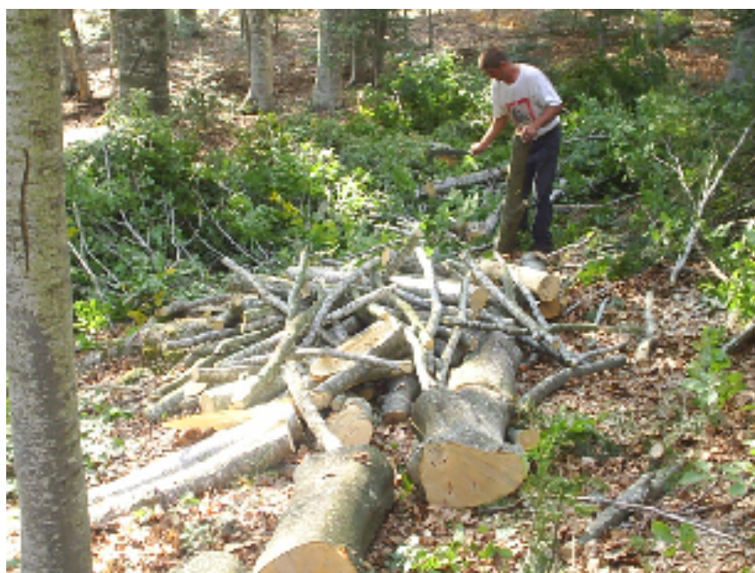
Foto:29. Abbattimento e allestimento, nelle faggete ,con motosega ,l'operaio non porta dispositivi di protezione.
