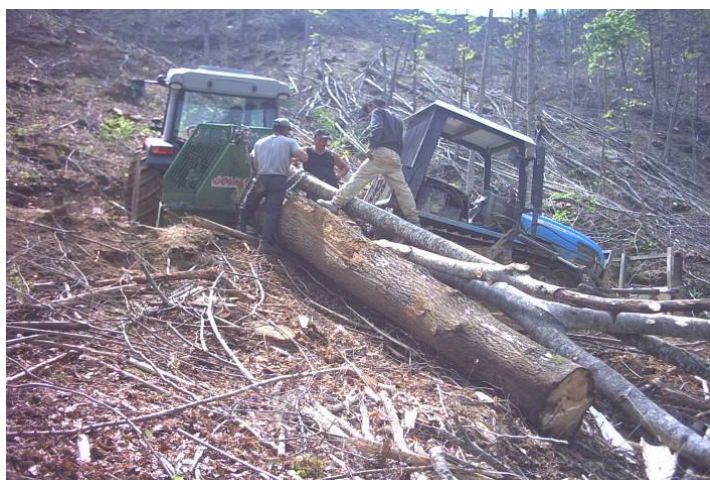
Foto 5: operatori senza DPI e macchine senza DPM durante una fase di esbosco
