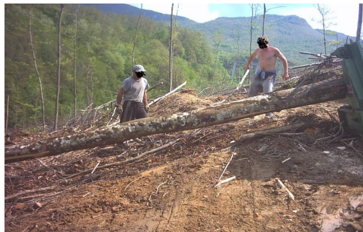
Foto 3: operatori pericolosamente vicino al carico esboscato e senza DPI
