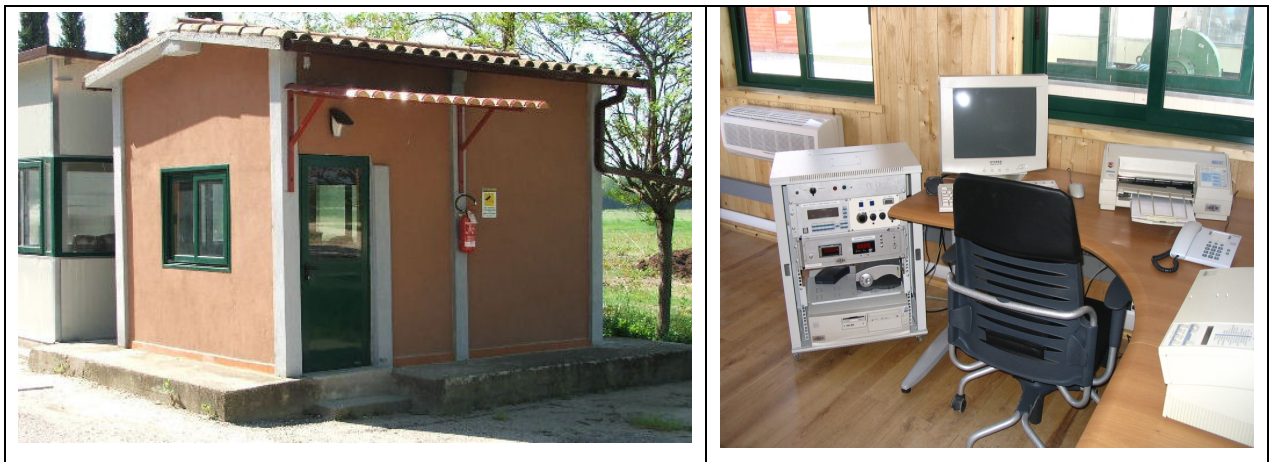
Figura IV.4 - Vista esterna ed interna della cabina di comando.
