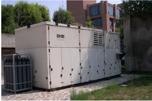
Figura 174: L'impianto da PAFC da 200 kW installato a Milano.[1]
