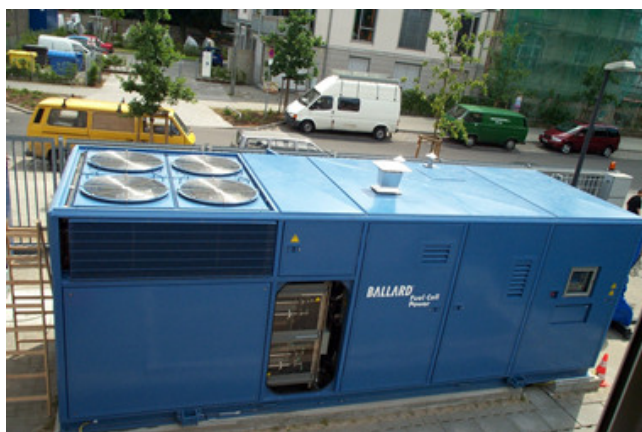
Figura 157: Impianto Ballard da 250 kW in Berlino.[1]
