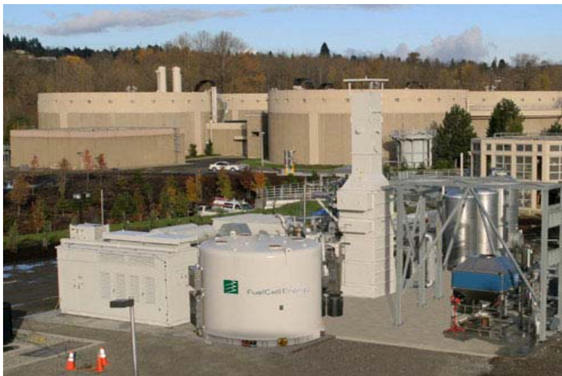
Figura 257 : Immagine del sistema MCFC da 1 MW presso l'impianto di depurazione di King County, USA.
