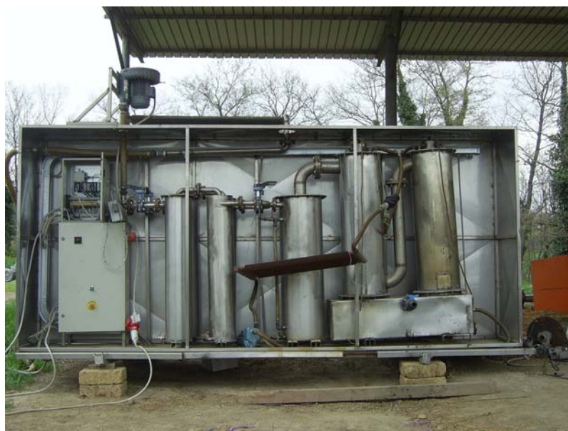
Figura 45 Vista della linea dei filtri del gassificatore multireattore
