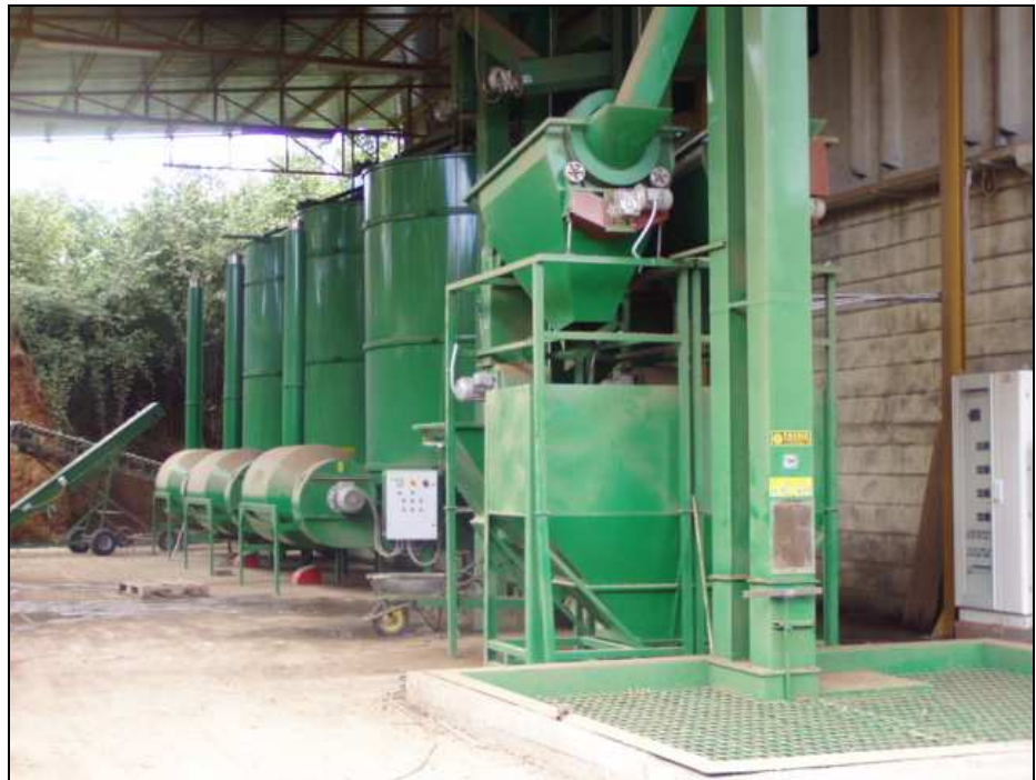
Foto 36 - Impianto con sistema di pulizia, scarico, pulizia e scarico del prodotto essiccato [Fonte: www.facma.it ]
