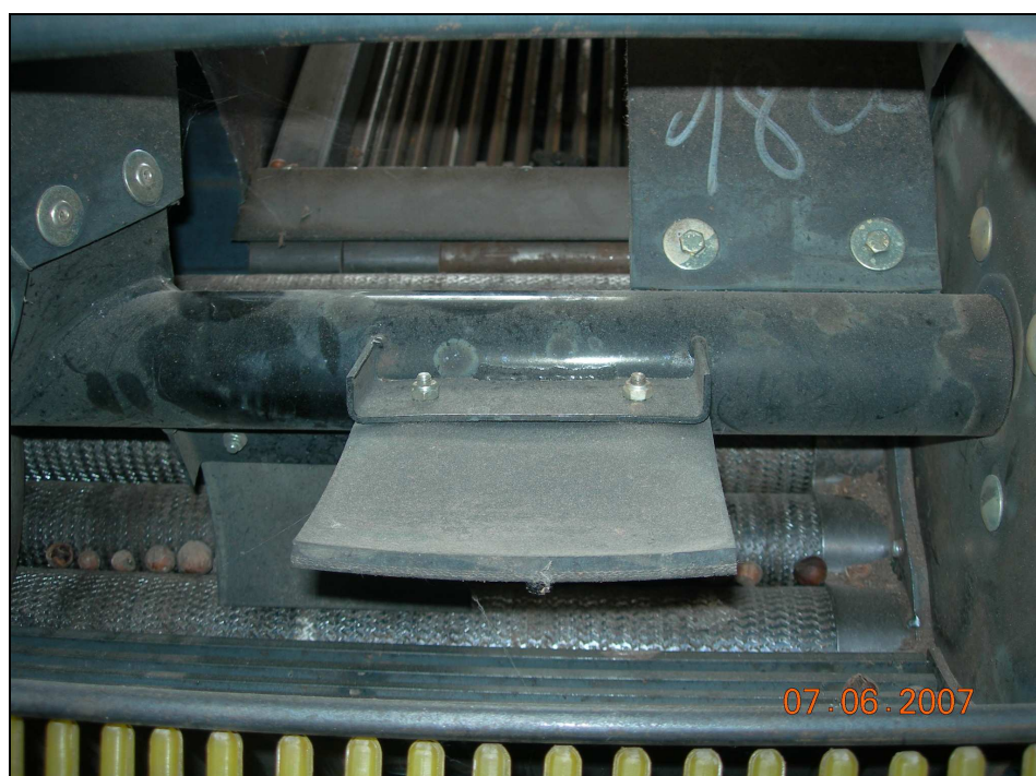
Foto 80 – la bocchetta di alimentazione ed il nastro trasportatore in corrispondenza delle palette gommate per l'alimentazione
