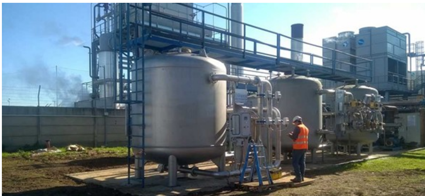
Figura 5.1: Impianto di dearsenificazione a servizio di un'industria alimentare
