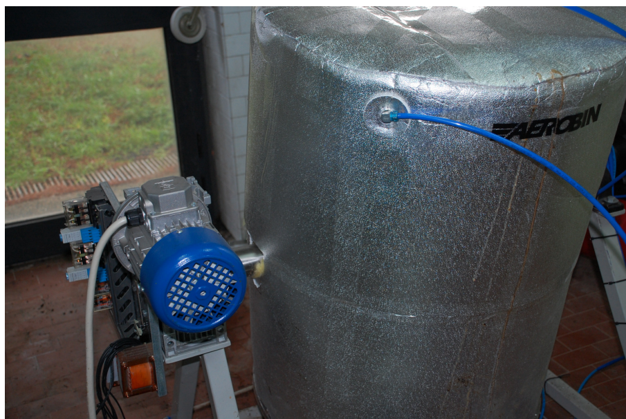
Foto 4.2 – Particolare del motore elettrico che garantisce la rotazione del cilindro.
