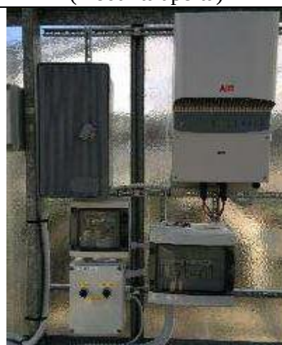
Fig. 15 – Sistema di controllo e inverter
