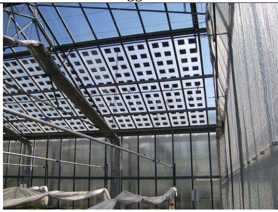
Fig. 23- Serra 2, impianto Silicio 60% ombreggiamento
