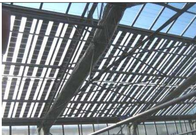
Fig. 75 - Esempio di integrazione totale di un impianto FV su serra
