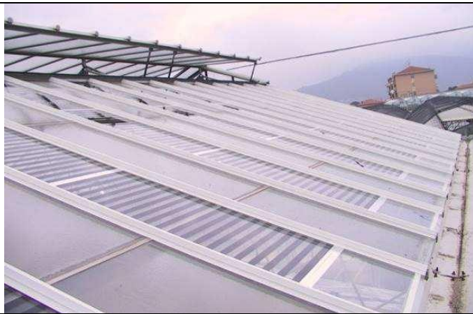
Fig. 77 - Dettaglio di un impianto completamente integrato con pannelli in CIS
