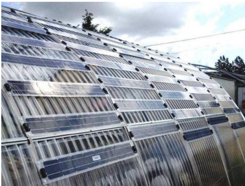
Tunnel fotovoltaico oggetto della ricerca
