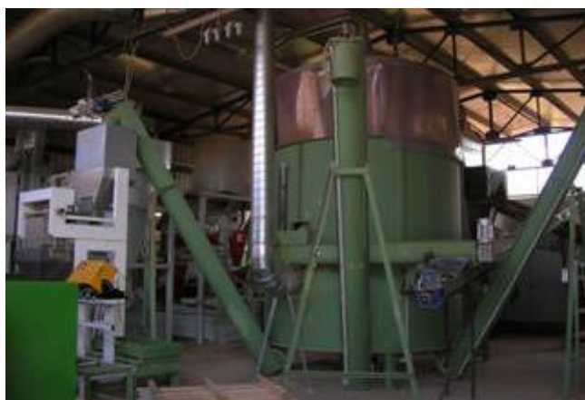
Figura 12: silos di vagliatura
