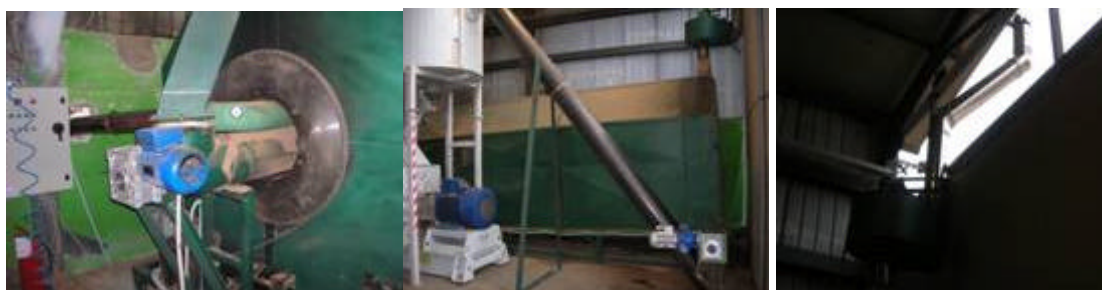
Figura 18: a sinistra dettaglio della coclea di caricamento e trasmissione a catena per la rotazione, al centro il sistema di coclee per lo scarico, a destra il ciclone ad aria forzata con condotto di scarico per il vapore
