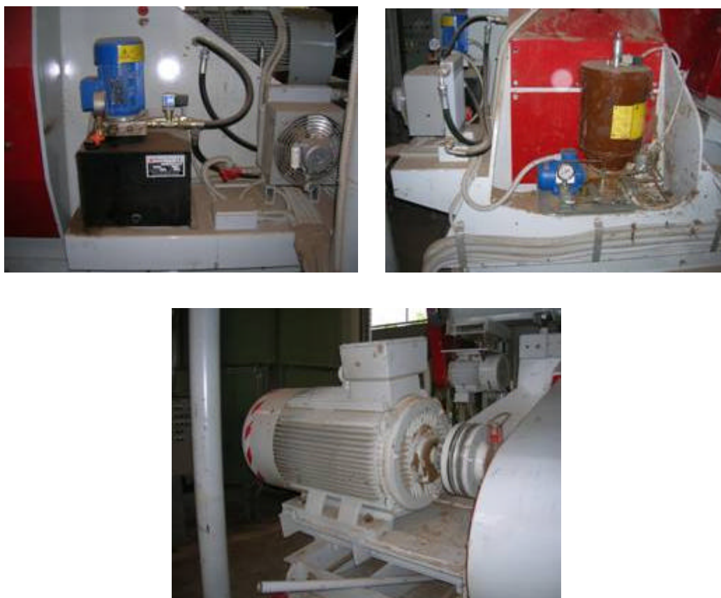
Figura 21: a sinistra centralina di pompaggio dell'olio; a destra serbatoio e centralina di pompaggio del grasso, sotto il grande motore primario
