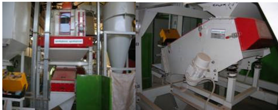
Figura 23: a sinistra il complesso di raffreddamento; a destra setaccio vibrante
