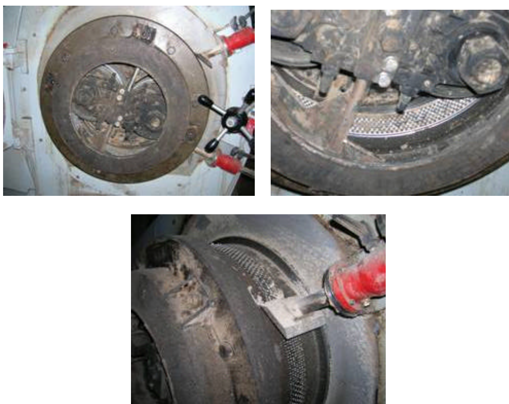
Figura 22: in alto a sinistra complesso del gruppo di pressatura, a destra particolare della trafilatura interna, sotto trafilatura esterna con coltello per la regolarizzazione del prodotto
