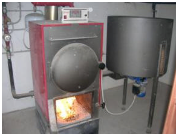
Figura 28: caldaia a cippato
