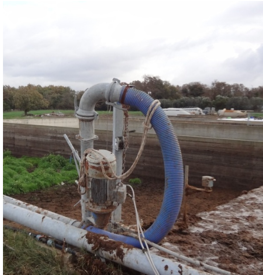
Figura 2-9: Particolare della pompa per la movimentazione del liquame
