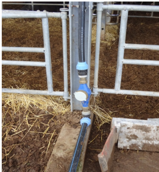
Figura 2-23: Contatore volumetrico per misurare gli apporti di acqua in sala d'attesa e di mungitura
