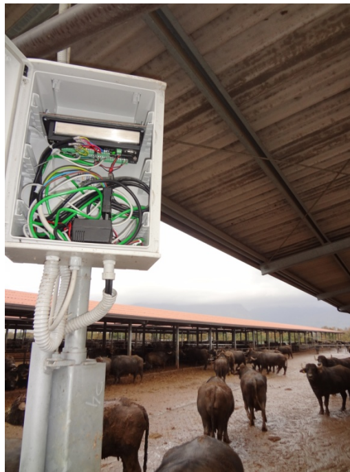
Figura 2-17: Cabina contenente il datalogger CR10X
