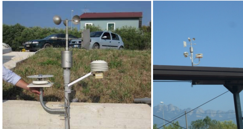
Figura 2-20: Assemblaggio e installazione finale dell'anemometro, piranometro e termoigrometro
