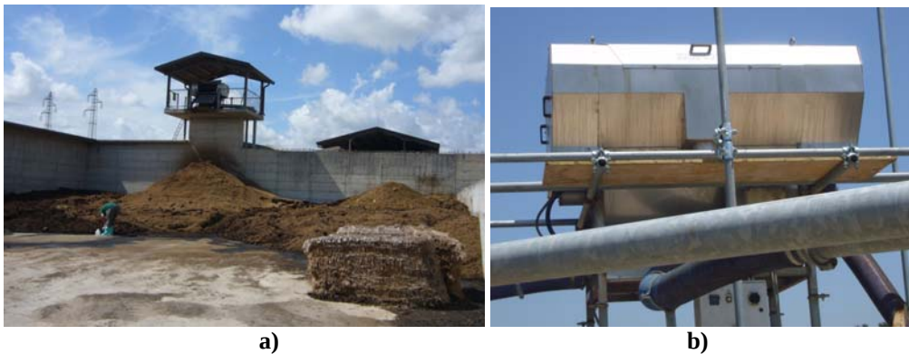
Figura 2-2: a) separatore a rulli con vista della corsia del separato solido; b) particolare del separatore a rulli
