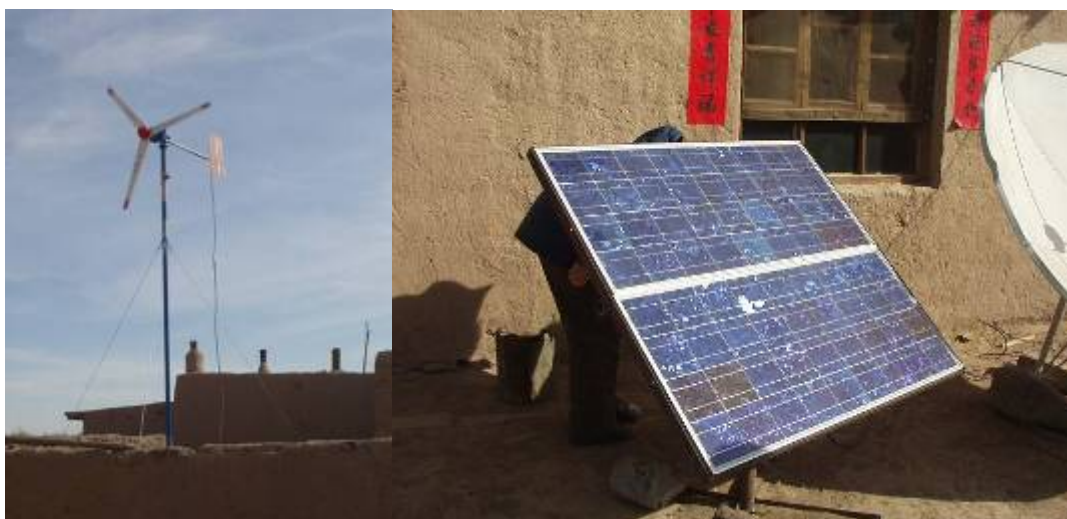
Figura 21 Rotore eolico e pannelli solari installati in una azienda di Jartai, Inner Mongolia (marzo '05)
