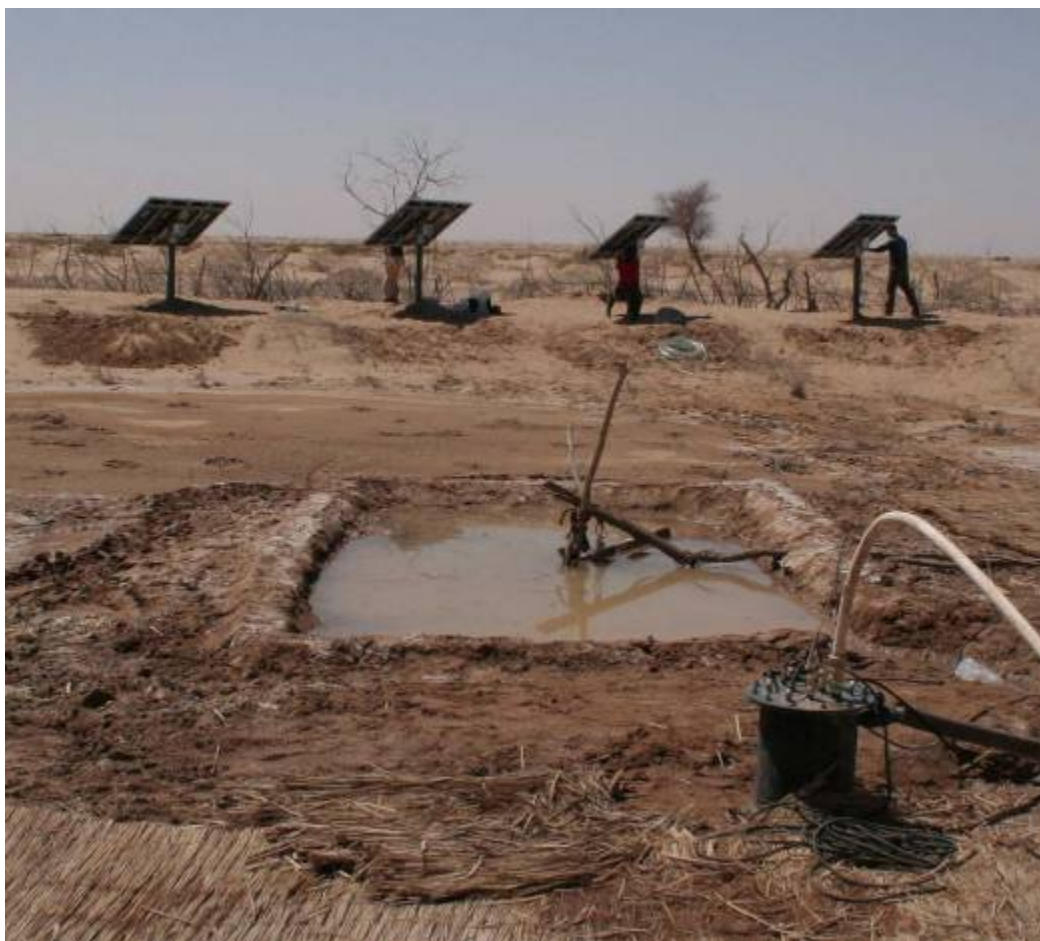
Figura 52 Set di pannelli solari per l'alimentazione del sistema di pompaggio, fasi dell'installazione aprile 2006.
