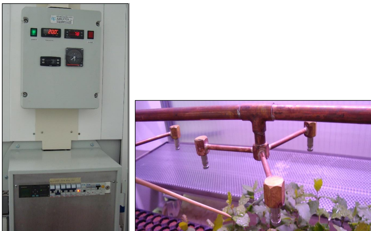
Figura 2.10 Particolare del PLC e dell'impianto di irrigazione.
