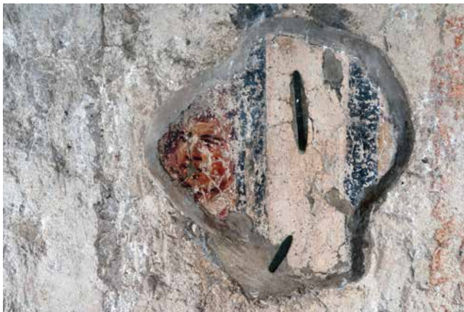
XI. Presbiterio, parete orientale, particolare di un frammento di intonaco dipinto fermato dalle stuccature in cemento e consolidato con grappe metalliche
