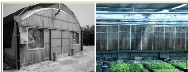
Figura 18. Nelle serre di propagazione la temperatura può essere controllata mediante il cooling system , cioè un impianto costituito da ventilatori (a sinistra) collocati su un lato della serra che estraggono l'aria interna e costringono l'aria in ingresso ad attraversare dei pannelli bagnati (a destra) abbassandone la temperatura.
