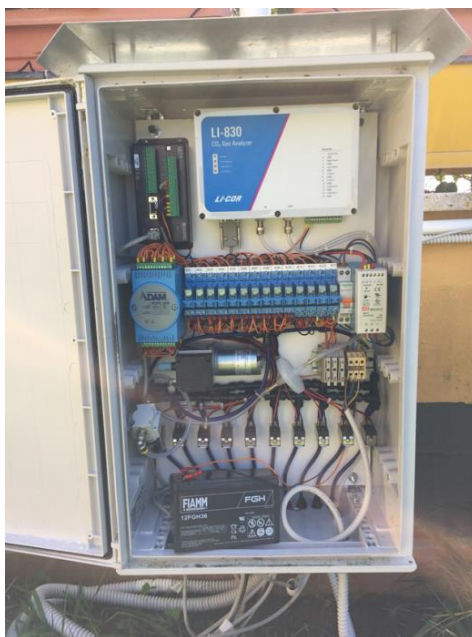
Figura 15 Cassetta di derivazione stagna contenente l'analizzatore dei gas, le pompe di prelievo e gli innesti da cui si diramano i punti di aspirazione.
