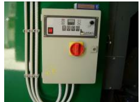
Figura 19. Quadro elettronico dei comandi della centrale termica
