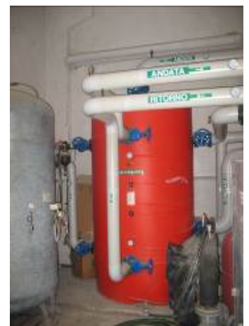
Figura 15. Accumulatore collegato all'impianto di riscaldamento
